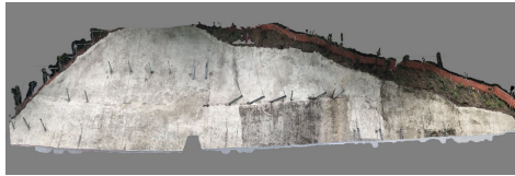
斜面Aにおけるひび割れ調査
