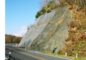
老朽化吹付法面
